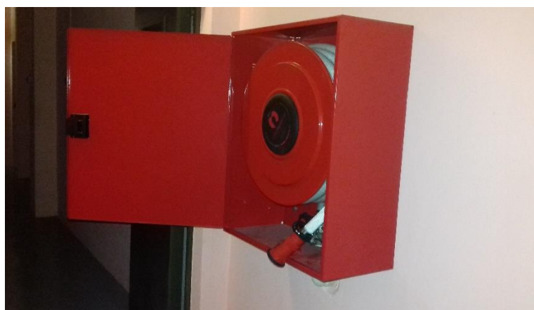
Fig. 11 – Novos carretéis e mangueiras de combate a incêndios
